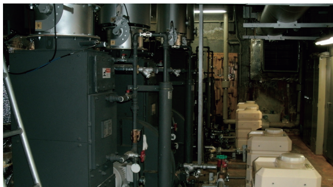
ドレン（復水）が再利用されていなかった（イメージ写真）
