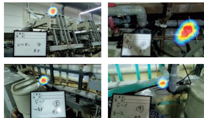
圧縮空気漏れ検知カメラによるエアリー漏れ調査(診断報告書より)
