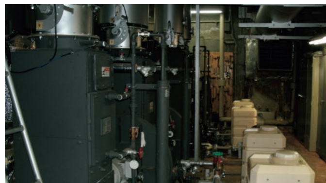
ドレン（復水）が再利用されていなかった（イメージ写真）
