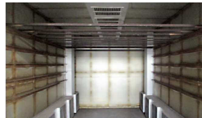
今回診断した乾燥炉の内部
